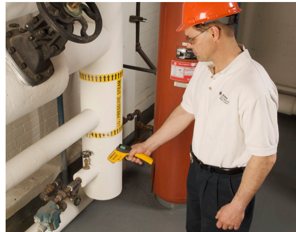
HVAC/발전소 관리자인 Darryl Dylla가 Fluke 62 적외선 온도계로 HVAC 시스템 전체에서 스팀 트랩을 점검하고 있는 모습
